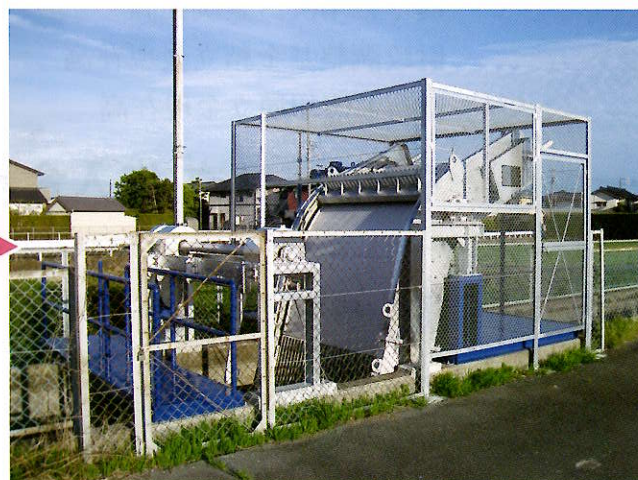
▲新堀除塵機（新）
